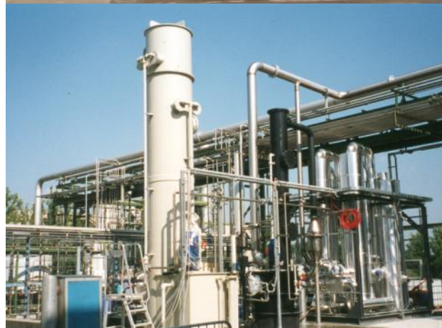
Impianto di criocondensazione, in esecuzione antideflagrante, preceduto da colonne ad assorbimento, una delle quali realizzata in polimero elettroconduttivo (SOLCHEM -LO-)
