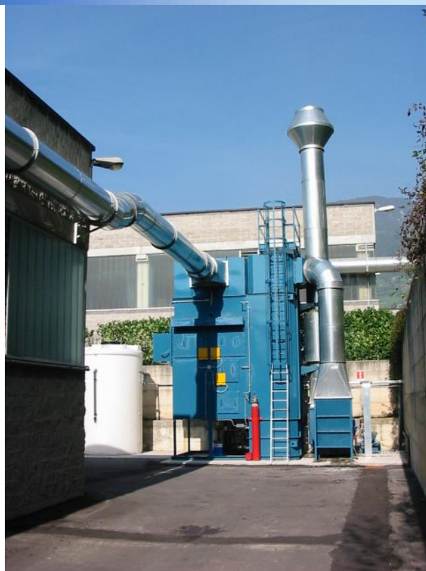
K-IND II installato su emissioni da forni di post-vulcanizzazione: data la vicinanza dell'impianto ai forni, oltre alla normale serranda tagliafuoco, per evitare possibili propagazioni di fiamma, il depuratore è dotato di impianto automatico di spegnimento a CO 2 . Sulla sinistra è visibile il serbatoio di raccolta per le acque di lavaggio filtro. (ARTEX)
