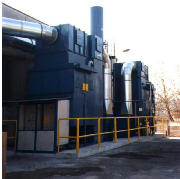
Dovendo trattare portate di notevole entità, è possibile installare due o più unità K-IND in parallelo: nella fotografia una doppia installazione su emissioni da presse di stampaggio (NIRA).
