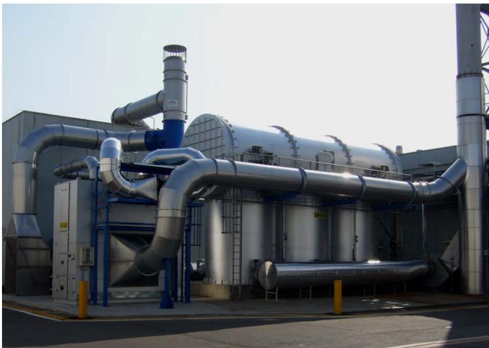
Figura 1 - Impianto per abbattimento solventi da fabbricazione vernici, formato da combustore rigenerativo (RTO) a tre camere e rotoconcentratore a zeoliti (a sin. nella foto).
