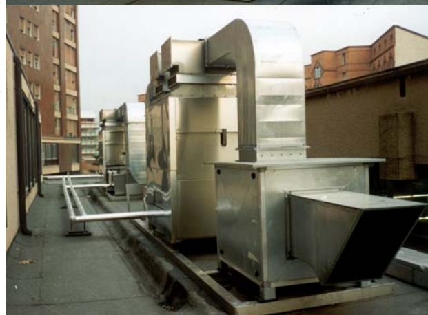
Installazione di più Sistema K su emissioni di una cucina ospedaliera. Ogni unità è dotata del proprio ventilatore di espulsione silenzioso, attivabile singolarmente.
