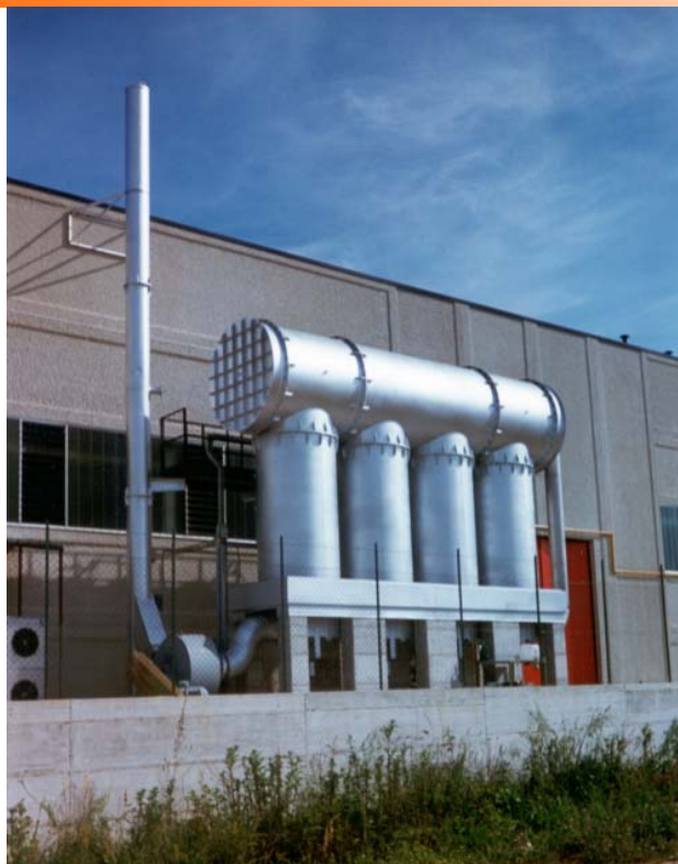
Combustore rigenerativo ceramico a quattro camere, impiegato per l'ossidazione di reflui provenienti dalla sinterizzazione di elettrodi in carbonio (EUROCARBO -AP-)
