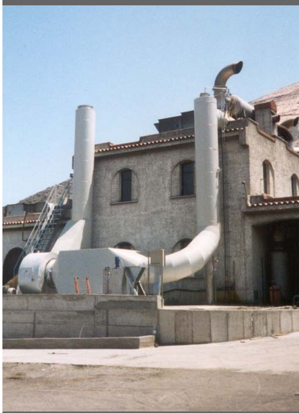
Reattore catalitico DENOX installato su emissioni di motori Diesel per generazione elettrica (ENEL -centrale elettrica isola di Vulcano-)
