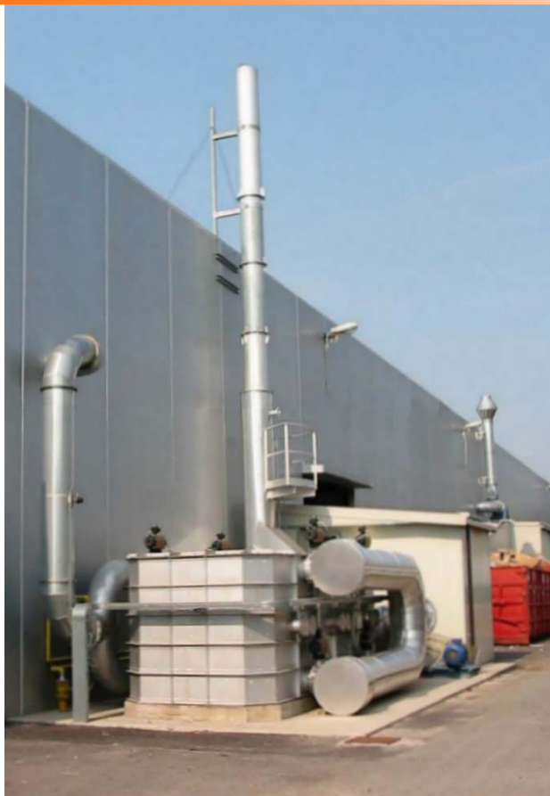
Combustore rigenerativo flameless tricamera, installato su emissioni di dicitopentadiene - DCPD (POLIRIM -BG-)
