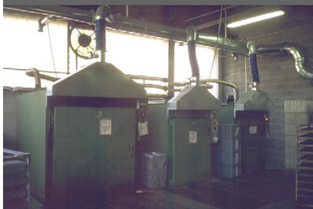
Cappe automatiche di aspirazione su forni di post-vulcanizzazione (ITALIAN GASKET)
