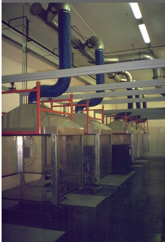
Cappe di aspirazione su emissioni durante il raffreddamento dopo trattamento in forno (ARTEX)
